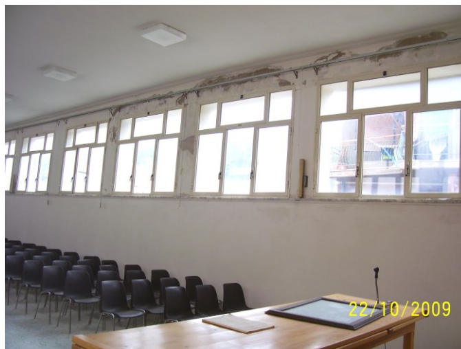
Parti degradate dell'aula
